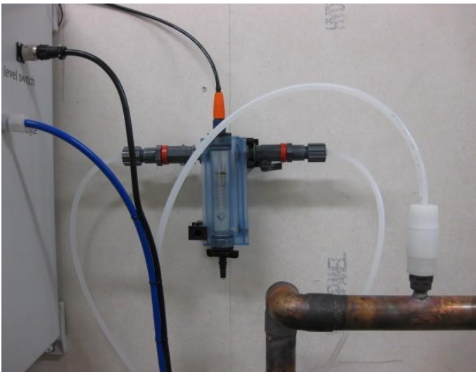
Celda redox y punto de inyección
